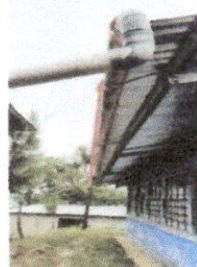
Foto 2: Instalación de canal en pésimas condiciones.
