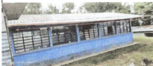
Foto 1: Nivelación y reparación de la estructura de la peña. Tubos PVC en mal estado que se ha servido como canal para recolectar agua de lluvia.
