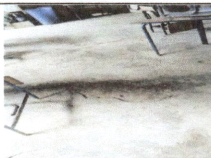
Foto 4: Piso del aula 4, se encuentra en malas condiciones y se necesita un cambio de piso.
