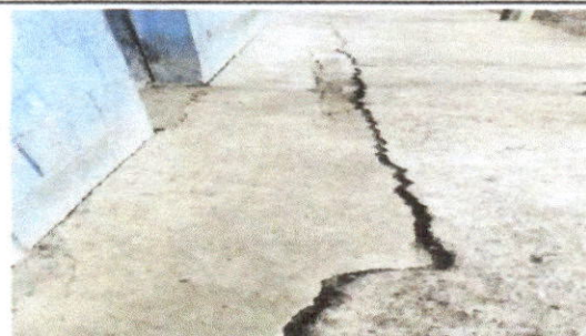
Foto 6: El piso del corredor se encuentra en mal estado y se necesita un cambio de piso.
